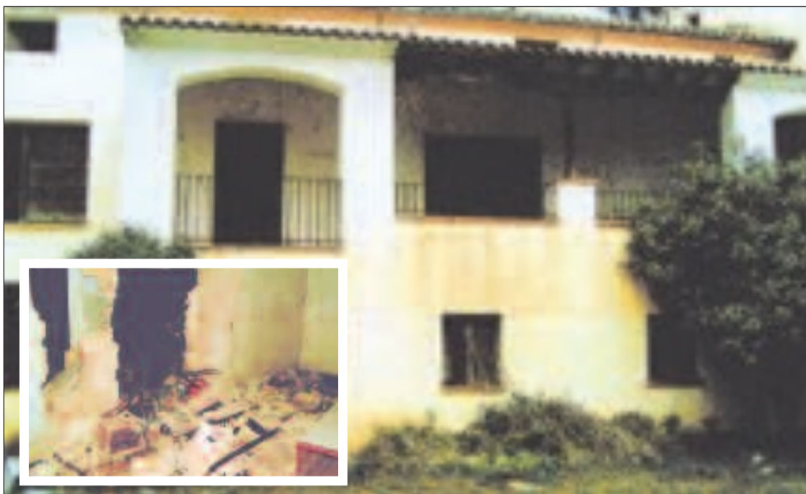
Estado actual de la masía Retiro Casa Nova, y destrozos en el interior en la foto pequeña
