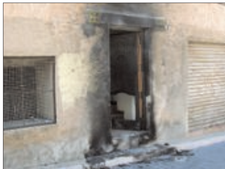
El incendio ha afectado también a la fachada de la sede de Cáritas
