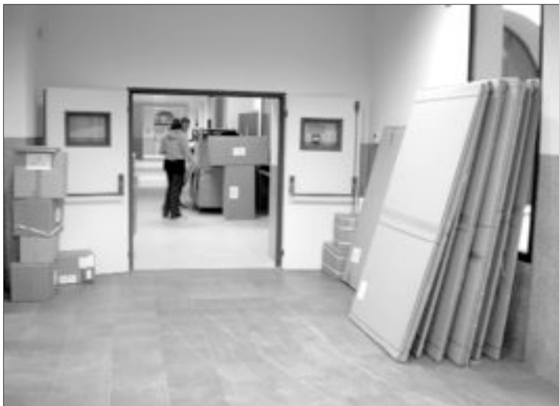
Esta semana han comenzado los trabajos para instalar todo el mobiliario y material escolar enviado por Conselleria
