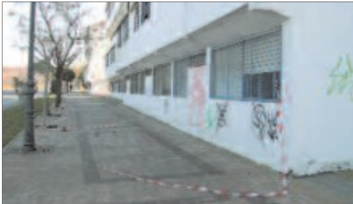
Los bomberos acordonaron la zona el lunes para comprobar los desperfectos en el tejado por el viento
