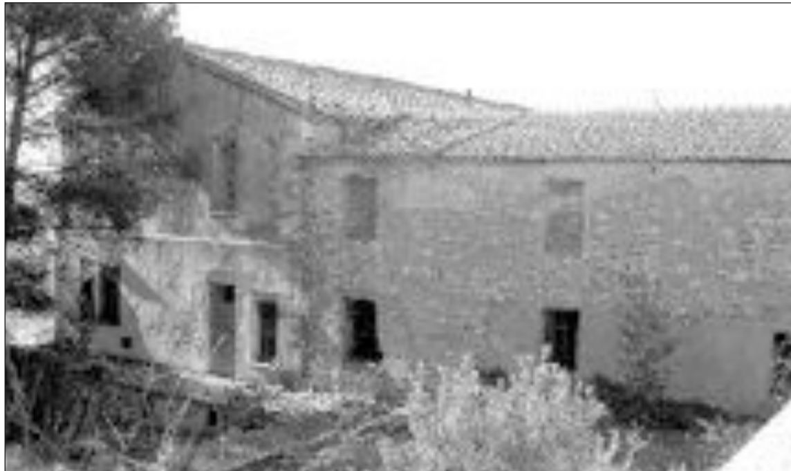
La estructura está bien conservada pero la cubierta tendrá que ser repuesta por una nueva
